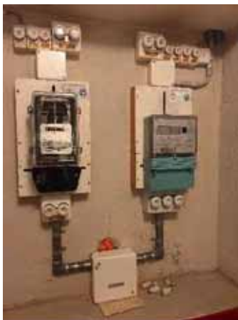
Elektronterverteilung in jedem Geschoss im Treppenhaus
