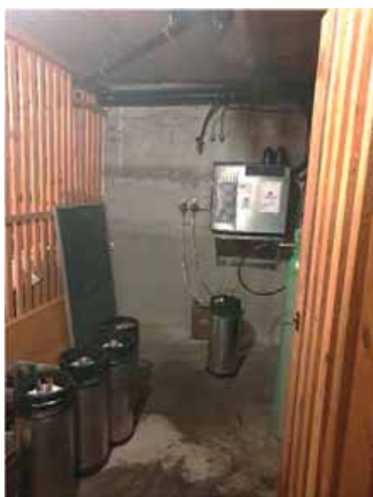
Bieranlage im Untergeschoss
