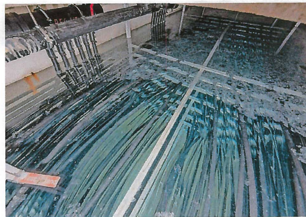
Der Eisspeicher fasst 35 000 Liter Frischwasser, das kühl bleibt, keine Algen ansetzt und deshalb nie ersetzt werden muss.
